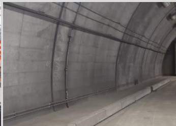
トンネル配管の腐食状況
