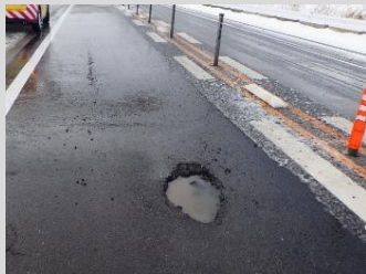
舗装の損傷状況
